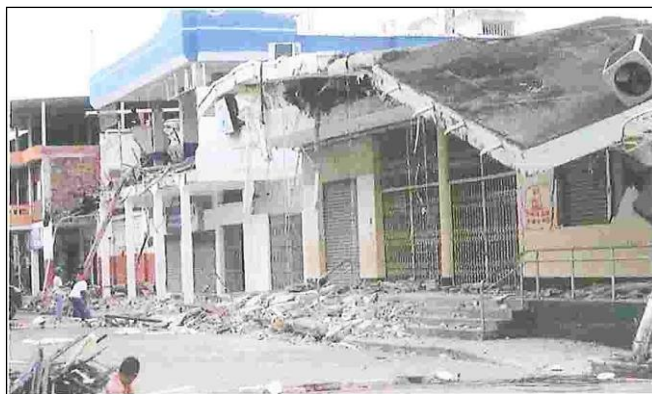
Imagen No. 24 – Colapso Palacio Municipal GAD Bolívar 16A
